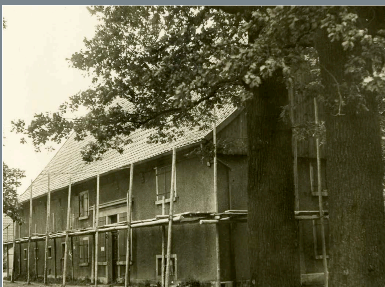
Restaurierung des Hauptgebäudes im Jahre 1954. Hier wurde u.a. der 1913 aufgetragene Putz entfernt und das Fachwerk wieder sichtbar gemacht. | Stadtarchiv Hamm
